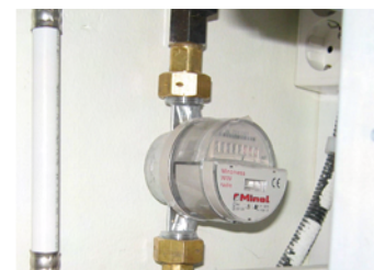
Varmvattenmätare i lägenheterna läses av med fjärravläsning.
