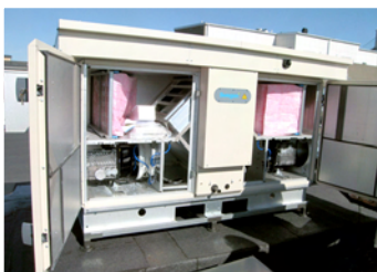
Hjärtat i systemet är ett Swegon Gold FTX-aggregat där in- och utluft växlas.
