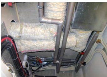
Individuellt eftervärmningsbatteri används för att de boende själva ska kunna styra sin inomhus-temperatur.
